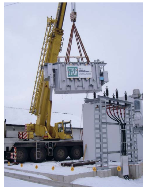
Ny transformator levereras till M3 i Lundsbrunn
